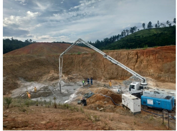
Foto 7: Cut-off 1 lançamento de 40m³ de concreto Fck 30 Mpa com sílica ativa, sobre topo rochoso 24/02/2023.
