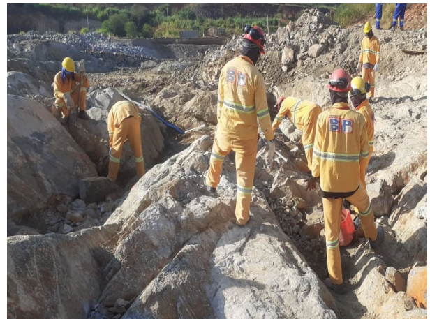
Foto 9: CUT-Off 1 entre estaca 28 com estaca 29: Consórcio BP realiza procedimento de "bate choco" sobre topo rochoso com uso de alavanca e limpeza manual grossa 06/04/2023.
