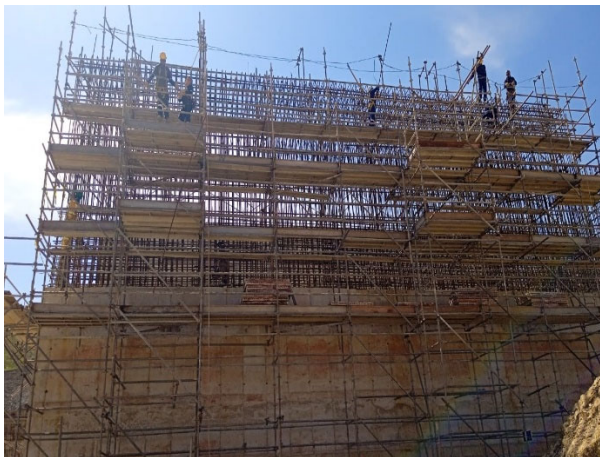
Foto 8: Módulo 2: galeria de desvio MD A montante Al Martins construção civil, seque com içamento de aço e armação da posição 2 da parede lateral esquerda da laje superior 18/03/20223.
